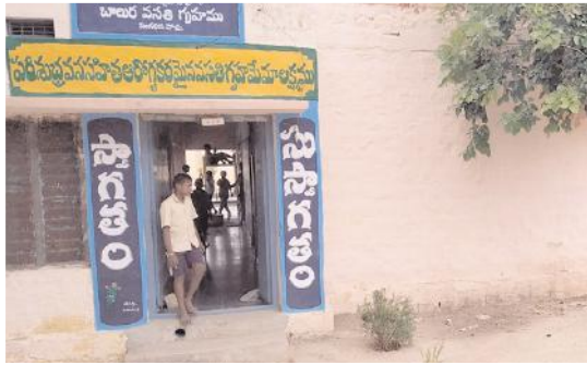
నిర్మించి 42 ఏళ్ళ అయినా మరమ్మత్తుకు నోచుకోక శిథిలావస్థకు చేరుకున్న హాస్టల్ ఇదే
