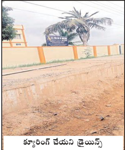
క్యూరింగ్ చేయని డ్రైయిన్
