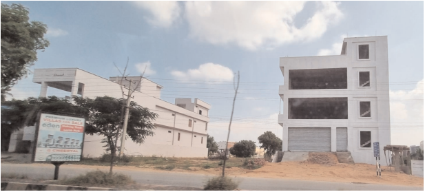
బెరల్ రింగ్ రోడ్డు సమీపంలో రేడియల్ రోడ్డులో అక్రమ బహుళ అంతస్తుల భవన నిర్మాణం
